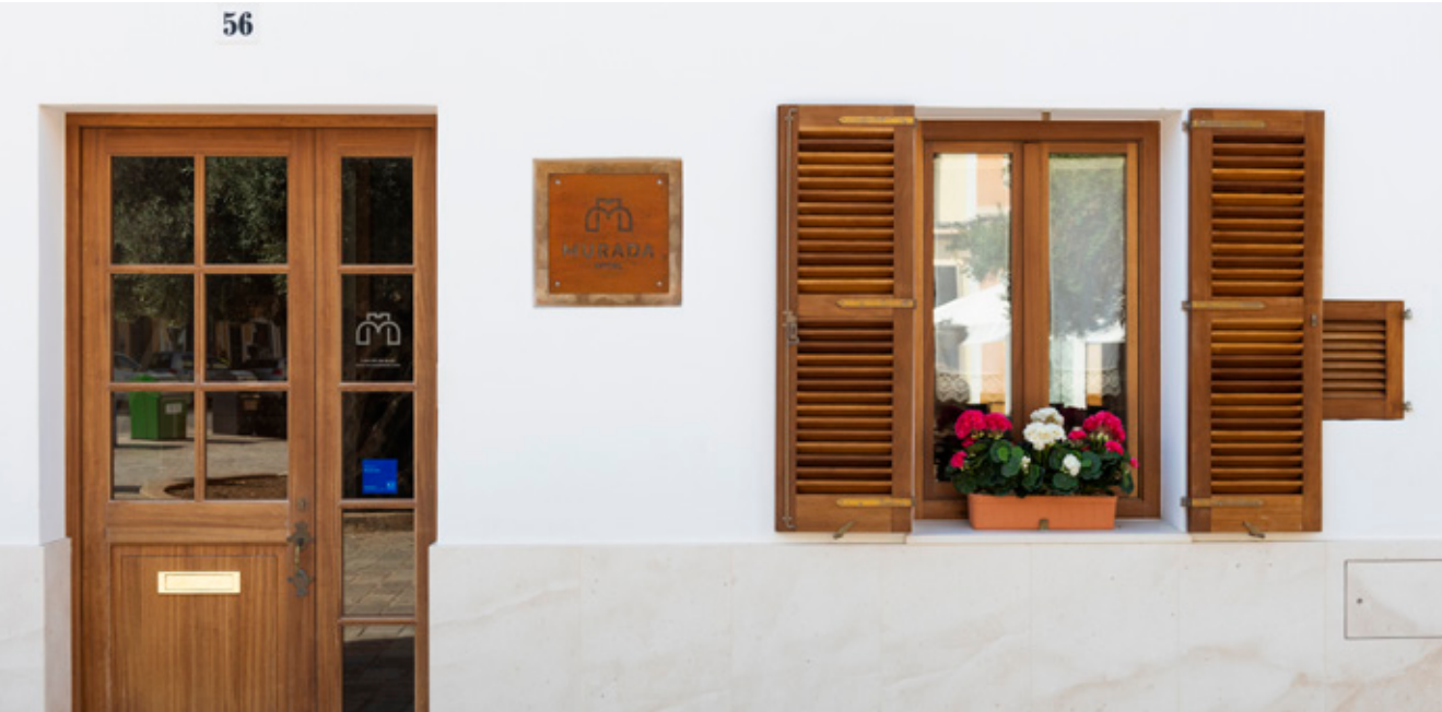
Es recomana que l’ajuntament exigeixi un manteniment permanent i continuat de tots els elements presents a les façanes dels edificis.
